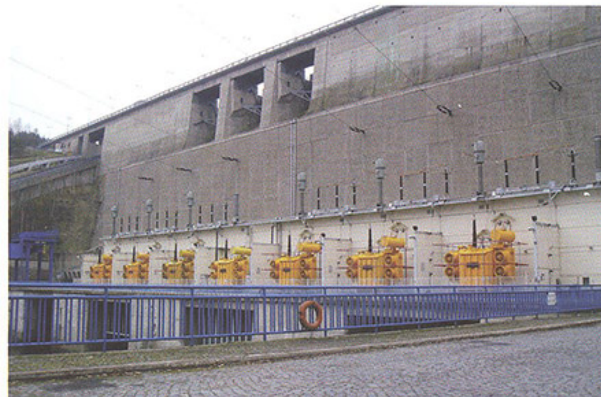
Vývody elektrárny Orlík
